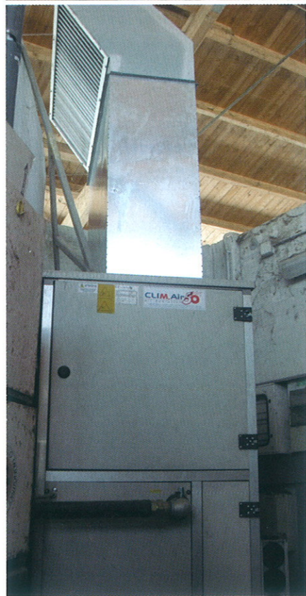
▼ Il calore proveniente dall'impianto del biogas è usato anche per il riscaldamento invernale della sala di mungitura.
